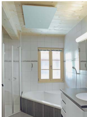
Infrarot-Heizsysteme verströmen wohlige Kuschelwärme.
