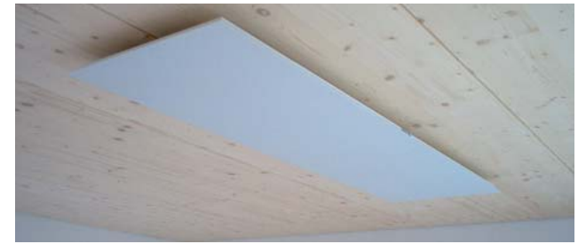
Die Grösse und Positionierung der einzelnen Elemente hängt im Wesentlichen von Bausubstanz und Heizvolumen ab.
